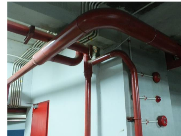
Gambar 2. 1.51 Pipa pemadam kebakaran
