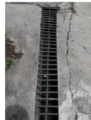
Drainase yang terdapat pada sisi timur site merupakan drainase tertutup
