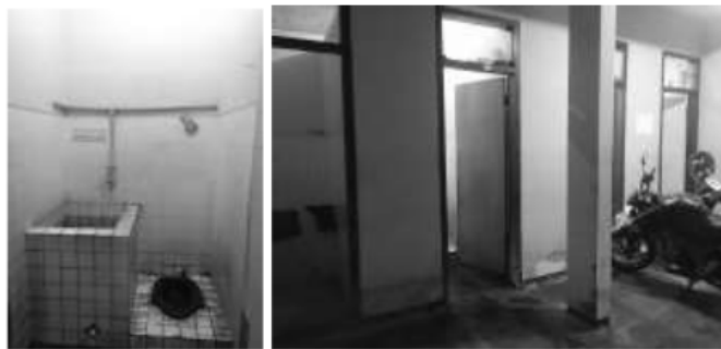
Gambar. 7 Kondisi kamar mandi rumah kos Sumber: Ujjanto, 2018
