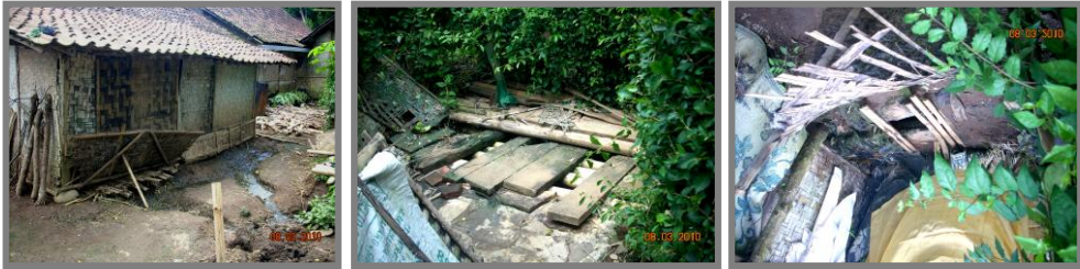
Gambar 6. Kondisi Saluran Buangan Air Kotor dan Kamar Mandi/WC Sumber: Studi Lapangan
