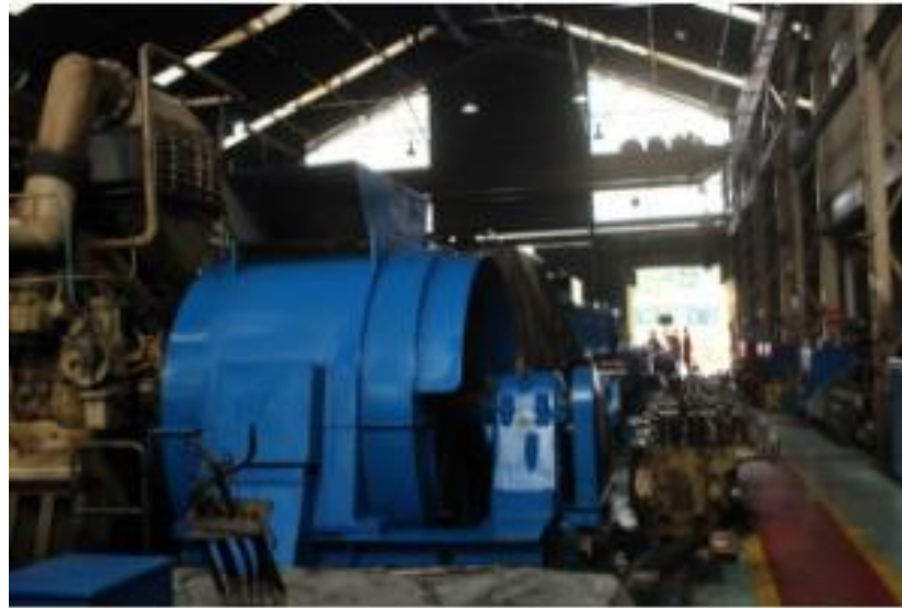
Gambar 2.4 Ruang Generator PLTD Gunung Malang Balikpapan
