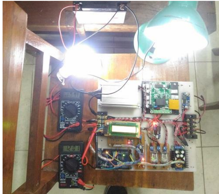
Gambar 4.8 Pengujian Pengisian Baterai Dengan Pembangkit Listrik Hibrida Panel Sel Surya 100 WP Dan Generator AC
