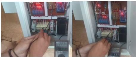
Gambar 4.7 Pengujian Pompa Cairan EM4 Menggunakan AVO Meter
