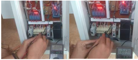
Gambar 4.6 Pengujian Pompa Air Kapur Menggunakan AVO Meter
