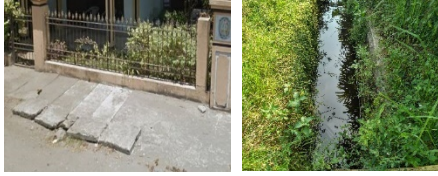
Gambar 4. 2Kondisi Drainase Sumber: Survei primer 2019
