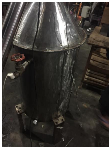
Gambar 3.2. Tabung air ( Evaporator ) Sumber: Dokumentasi Pribadi (2020)
