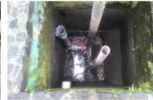
g. filter sudah terpasang
