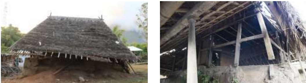
Gambar 5.2. Bale Tani di desa Beleq Senaru yang runtuh akibat gempa Lombok 2018 (photo: Gatot AS)
