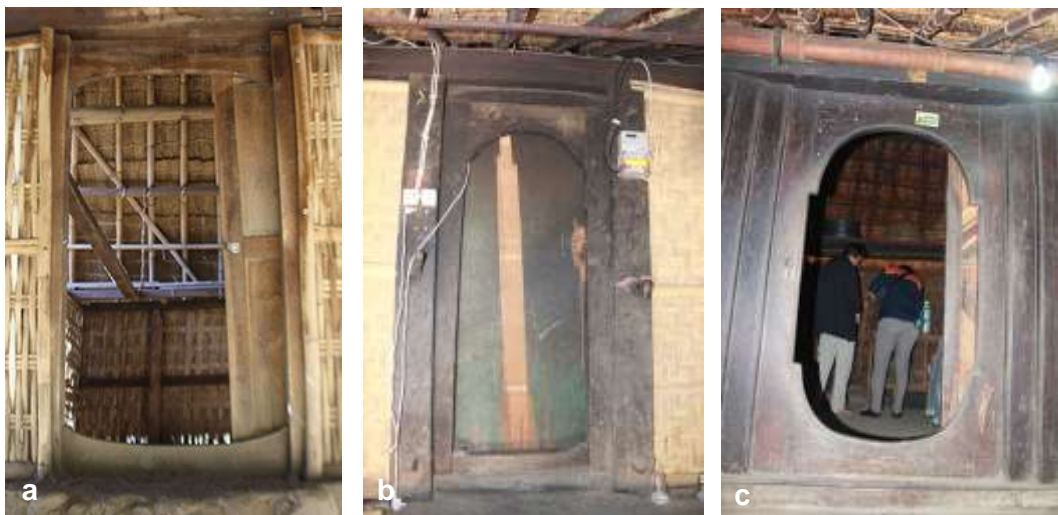
Gambar 5.11. Penanding lawang (kusen pintu) untuk masuk ke ruang inaq bale di (a) Sembalun, (b) Limbungan, dan (c) Sade. (photo: Gatot AS)
