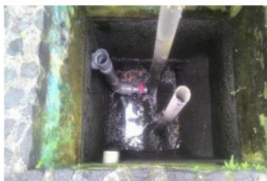
a. filter sudah terpasang
