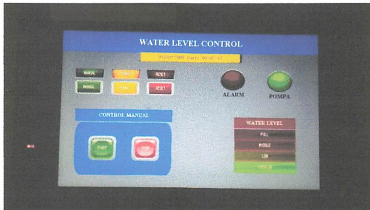
Gambar 4.27 Kondisi Level Air "verylow" pada HMI
