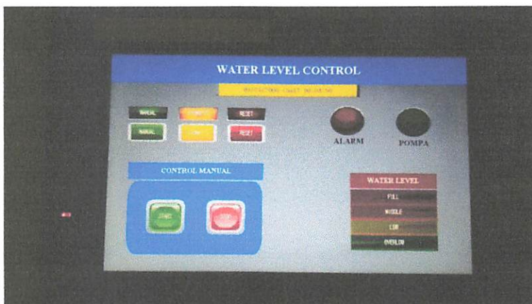
Gambar 4.26 Kondisi Kontrol Otomatis
