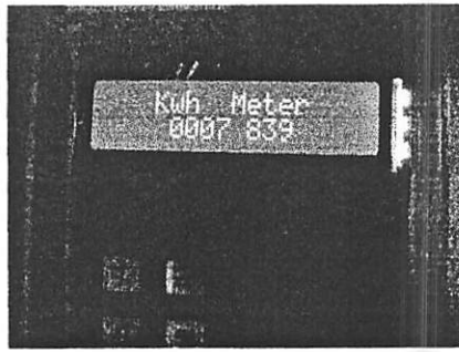
Gambar 4.29. Kwh meter pada LCD
