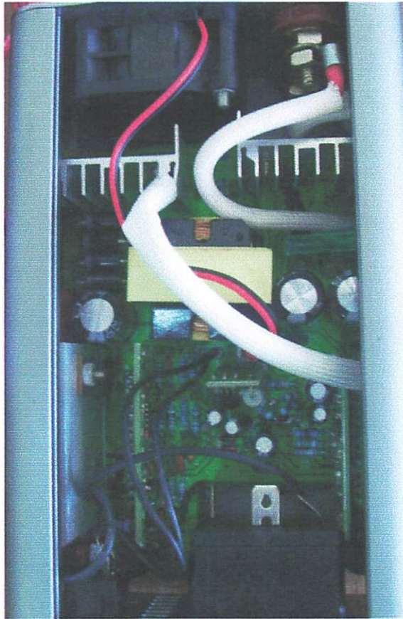
Gambar 4.27 Inverter sebagai PMC
