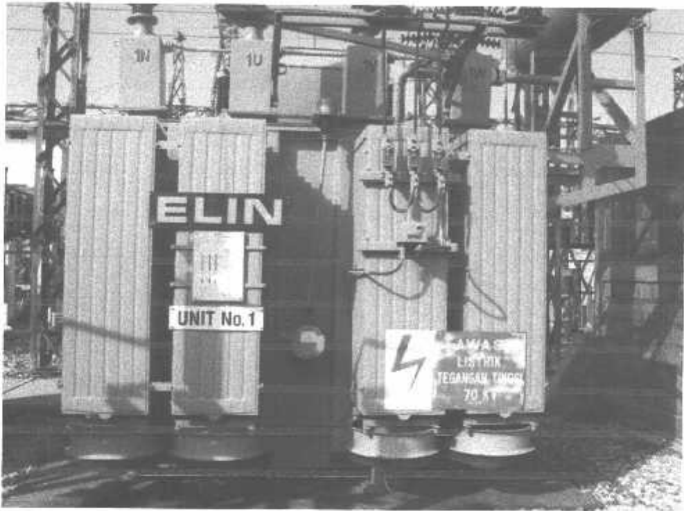
Gambar.3.2 Transformator Utama 11/70 kV
