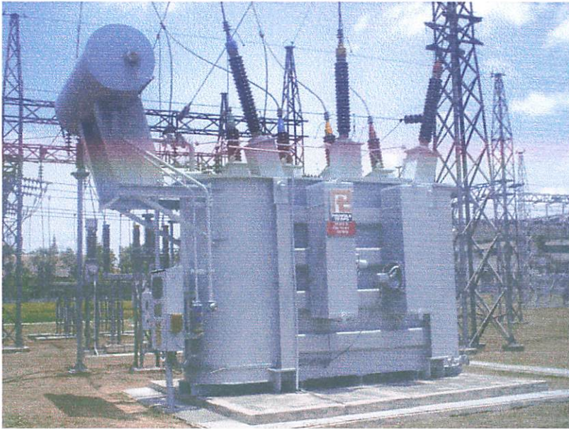
Gambar 3-3 : Inter Bus Transformer 150/70 kV pada GI. Kebonagung UPT Malang
