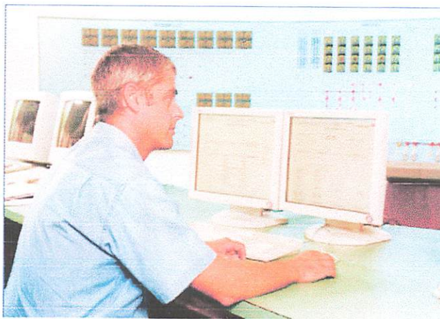
Gambar 2.18 Komputer sebagai panel monitoring dan pengendalian pada SCADA [2]
