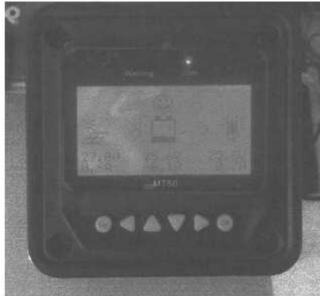
Gambar 4. 10 Tampilan pada display charger control pada jarak 40 meter
