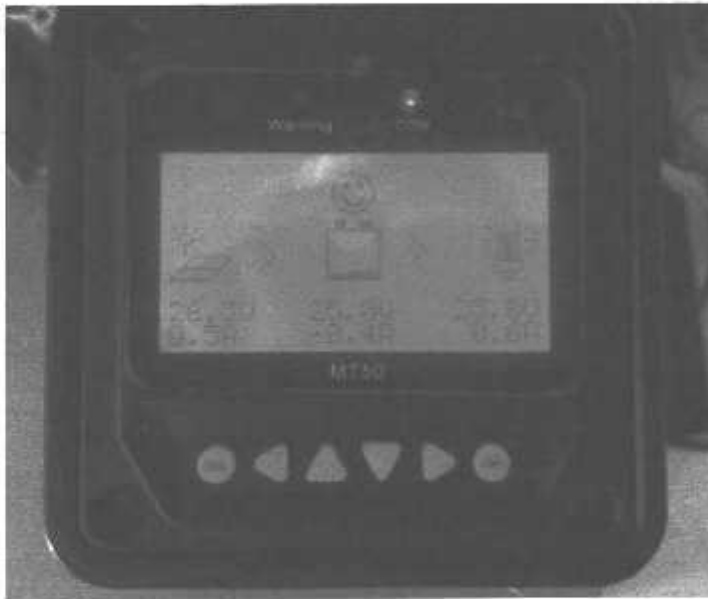
Gambar 4. 8 Tampilan pada display charger control pada jarak 20 meter
