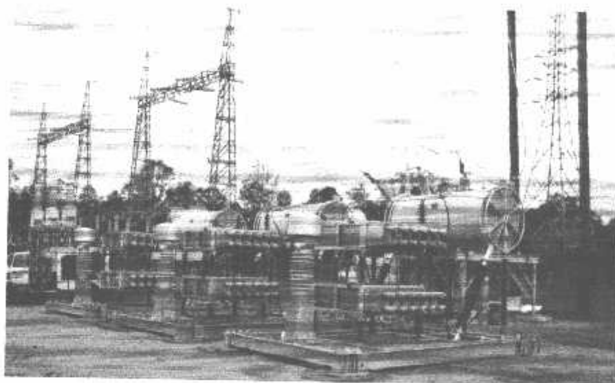
Gambar 2.8 Kapasitor Yang Dipasang Pada Gardu Induk
