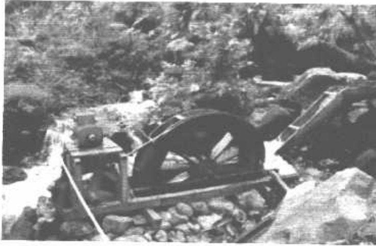
Gambar 2.14 Pembangkit Listrik Tenaga Mikrohidro
