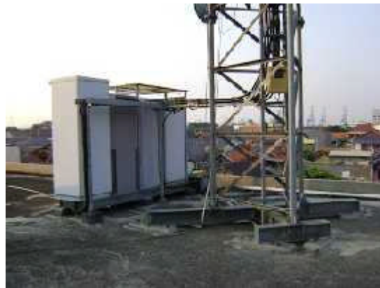
Gambar 2. 1 Menara pada rooftop gedung
