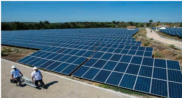
Gambar 2.5. contoh penggunaan PV sebagai pembangkit pada PLTS kupang.
