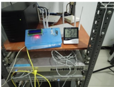
Gambar 15. Pengukuran Suhu pada Ruang Server
