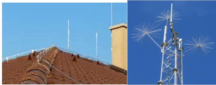
Gambar 4.34 Contoh penangkal petir di atap bangunan dan di atas menara komunikasi (Sumber: Dokumentasi Pribadi)
