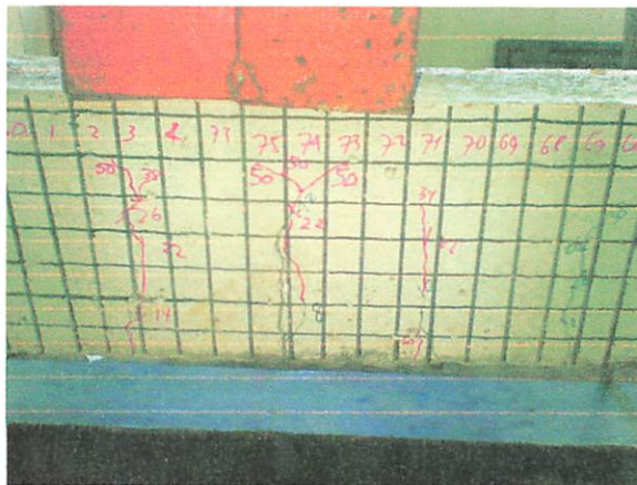
Gambar 4.14 Rekam retak yang terjadi pada balok variasi 2 A
