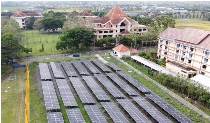
Gambar 3.6 PLTS ITN Malang 0,5 MWp
