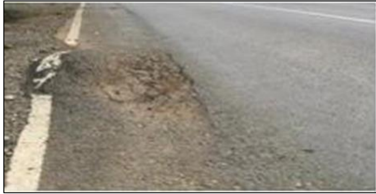
Gambar 2. 4 Alur Bekas Roda ( Rutting ) (Bina Marga, 2011)
