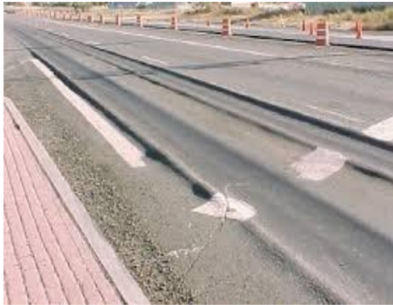
Gambar 2.5 Kerusakan tonjolan dan lengkungan
