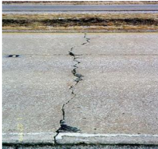
Gambar 2.4 Kerusakan retak blok
