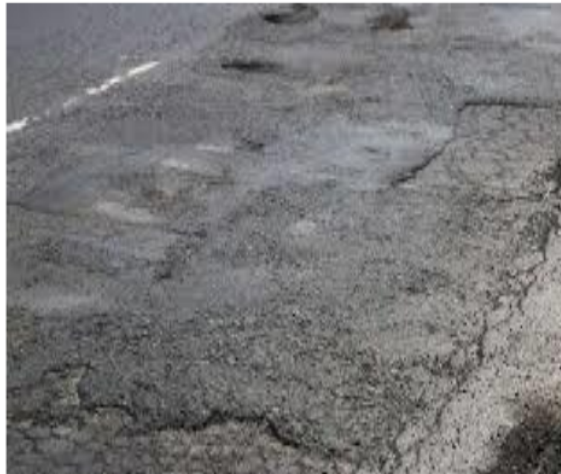
Gambar 2.8 Kerusakan tambalan dan galian utilitas
